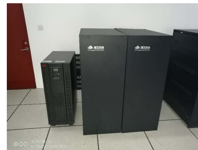
图 4-8 收费站机房 UPS
